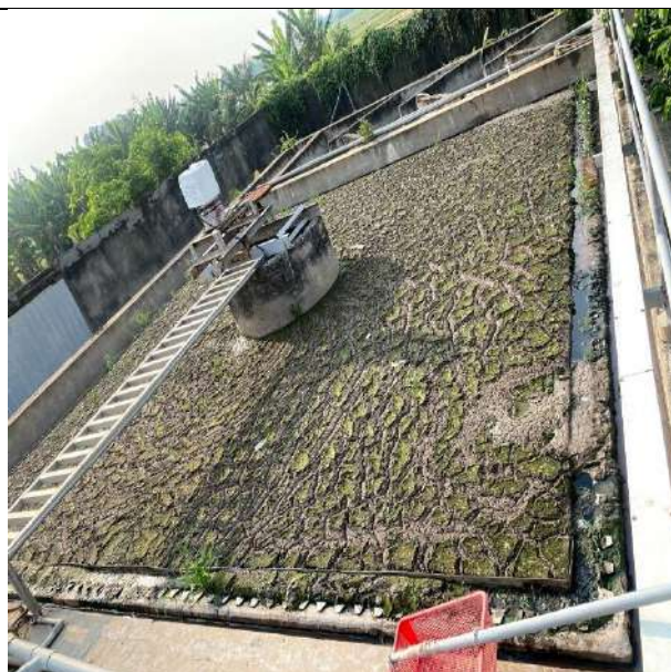
Bùn nổi bề mặt bể lắng
